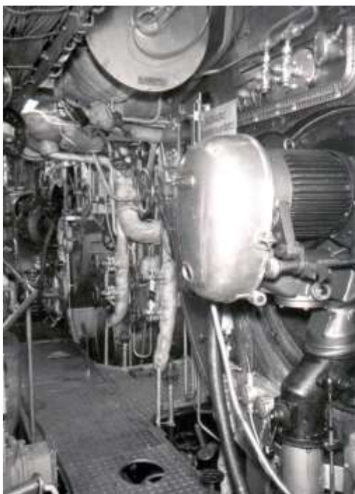
WAHODAG-Kessel im Kraftwerk Mitte
